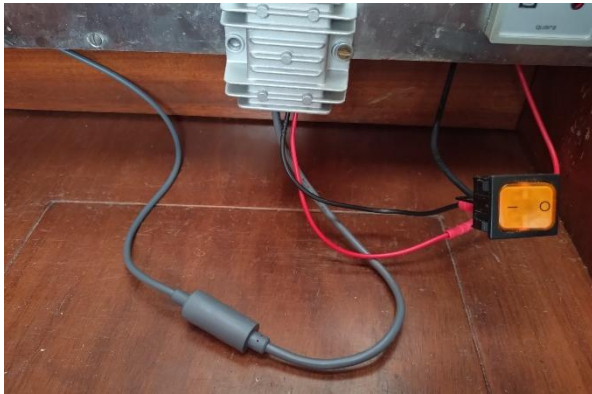
Die provisorische fliegende Verdrahtung
